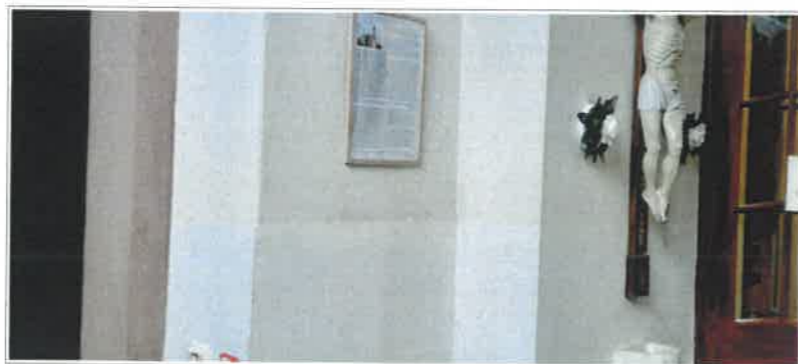
Fotografia nr 8/10 - widok ubytków farby
