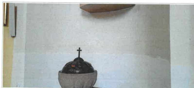
Fotografia nr 4/10 - widok pęknięć oraz ubytków farby
