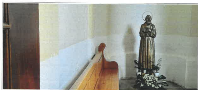
Fotografia nr 6/10 - widok pęknięć oraz ubytków farby
