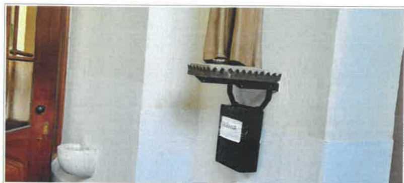
Fotografia nr 7/10 - widok ubytków farby
