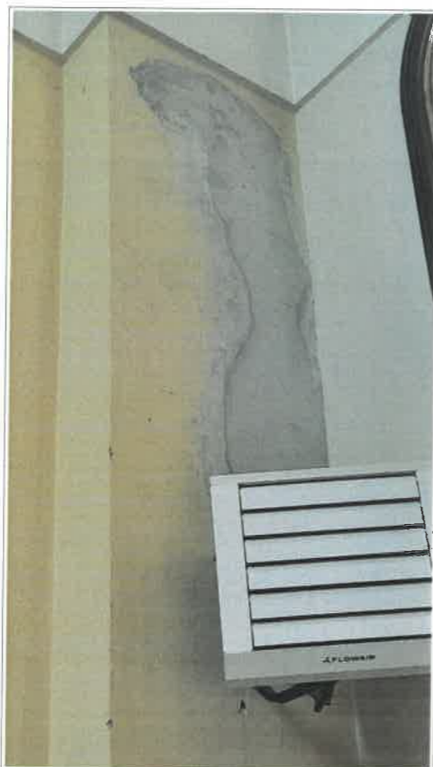
Fotografia nr 2/10 - widok uszkodzeń tynku przy montażu instalacji grzewczej
