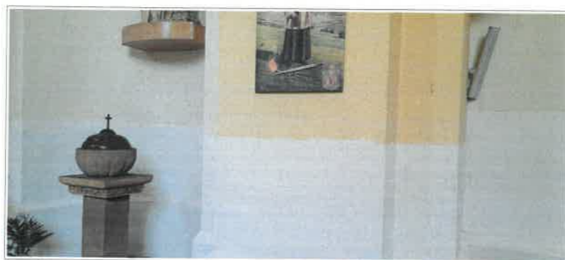
Fotografia nr 3/10 - widok pęknięć oraz ubytków farby
