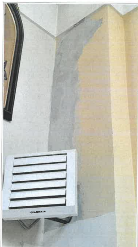
Fotografia nr 1/10 - widok uszkodzeń tynku przy montażu instalacji grzewczej
