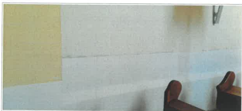
Fotografia nr 5/10 - widok pęknięć oraz ubytków farby
