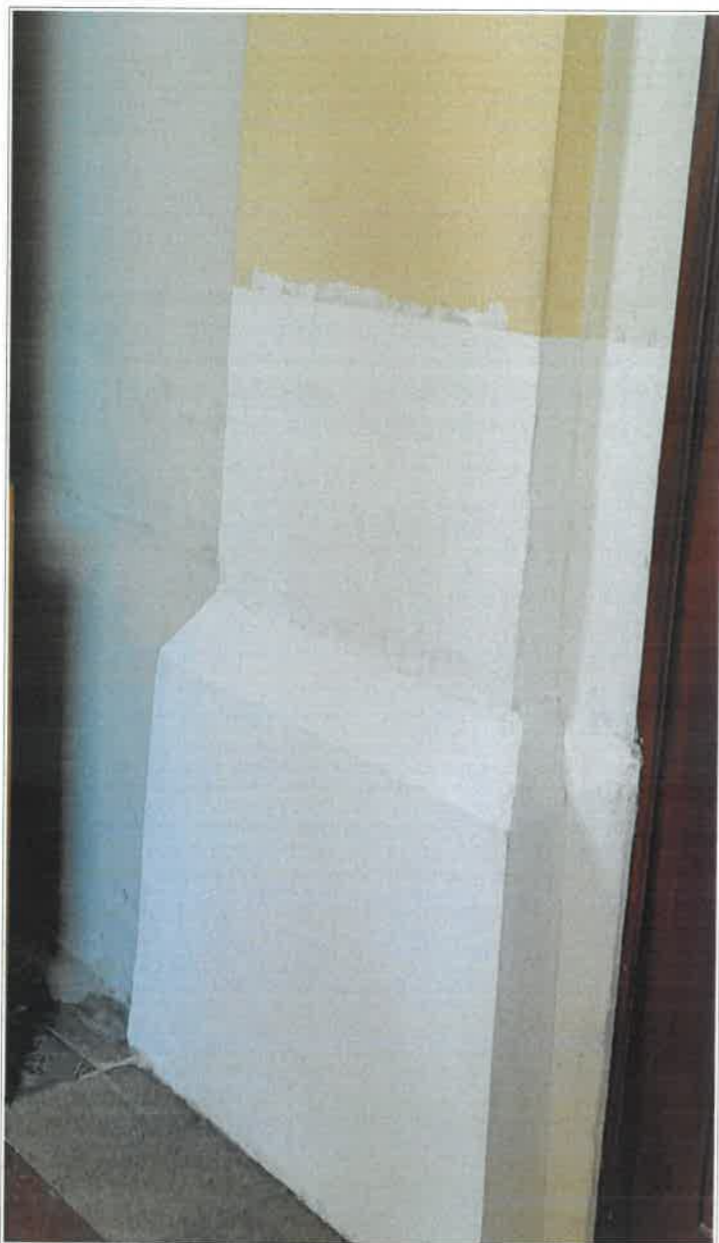
Fotografia nr 9/10 - widok ubytków farby
